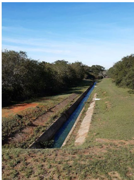
Figura 123 – Emissário no SES Freeway.
